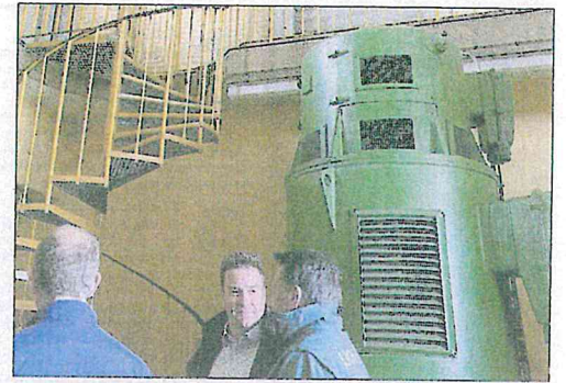
Ein Blick in das Schöpfwerk zeigt eine der riesigen Pumpen, die jeweils 4 Kubikmeter Wasser pro Sekunde fördern können und jeweils einen eigenen Notstromgenerator (auf der Empore) haben.
